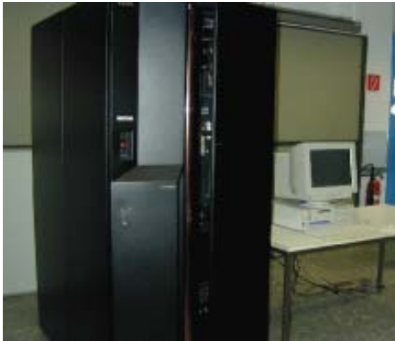
Abb. 2: Einer der IBM-eServer-p690-Türme im Maschinenraum der GWDG
